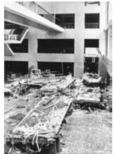
FIGURA 12-1 Un piso elevado se colapsa en un hotel de Kansas City en 1981. En el ejemplo 12-9 se considera cómo un sencillo cálculo de física pudo haber prevenido la trágica pérdida de más de 100 vidas.
