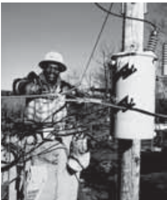
FIGURA 29-23 Reparación de un transformador de bajada en un poste de transmisión de alto voltaje.
